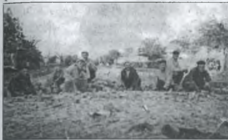
Бригада майстра Олександра Єгоровича БІЛОГО за роботою на потужній шашкою дороги на вул. Базарній у м. Гуляйполі (1959-1960 р.р.)
