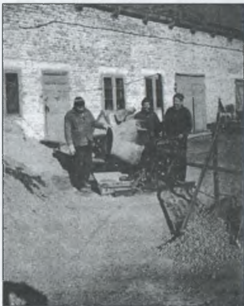
Бригада по виготовленню бетону для тротуарної плити у складі Володимира Павловича ЗАКАРЛЮКИ, Сергія Григоровича СОВИ і Григорія Андрійовича ГУРИ
